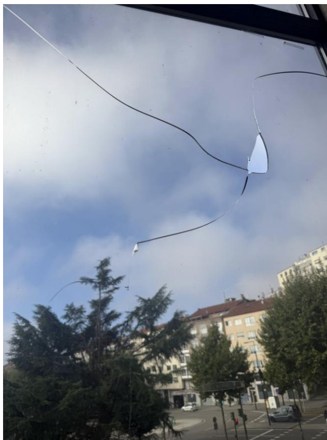
Foto 3 – Detalle da fisura, mostrando o seu percorrido por varias direccións do vidro.
