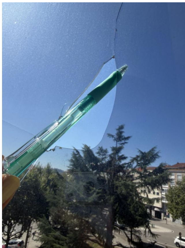
Foto 5 – Detalle de proximidade da fissura (bolígrafo como referencia de escala).
