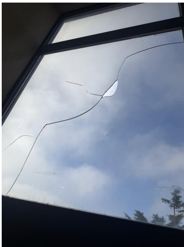
Foto 2 – Detalle da fisura e do fragmento de vidro ausente.
